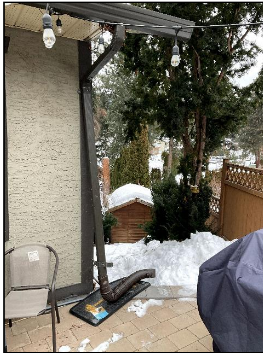
43. Uneven (trip hazard)
